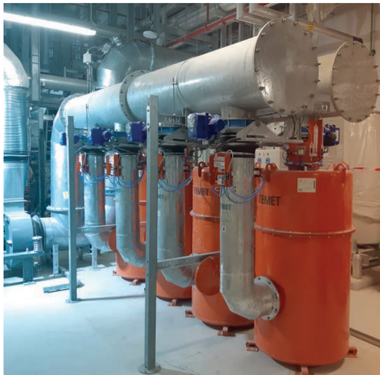
CBRN濾過ユニット
